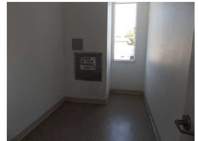
Trash Chute Door
